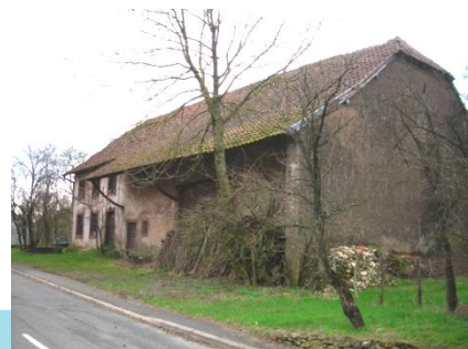
Exemple de ruine dans le centre ancien
